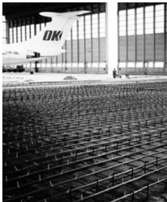
Напольное отопление для промышленных зданий
